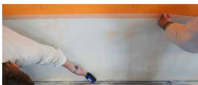
Ausgebesserte Stelle mit neuer Tapete
